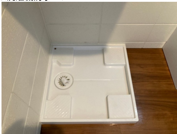
8.洗濯機防水パン
